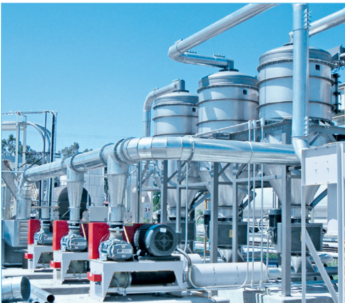
Entladung eines Silos für mehrere Schüttgüter
